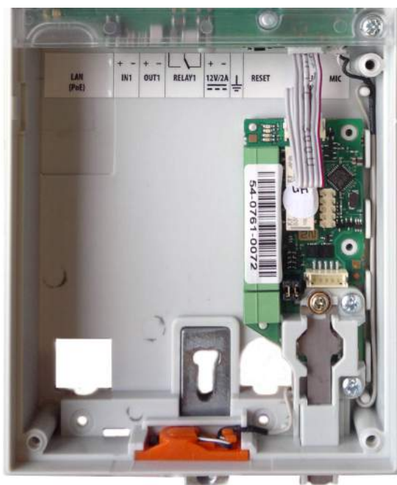
Obrázek: Montáž ochranného spínače
